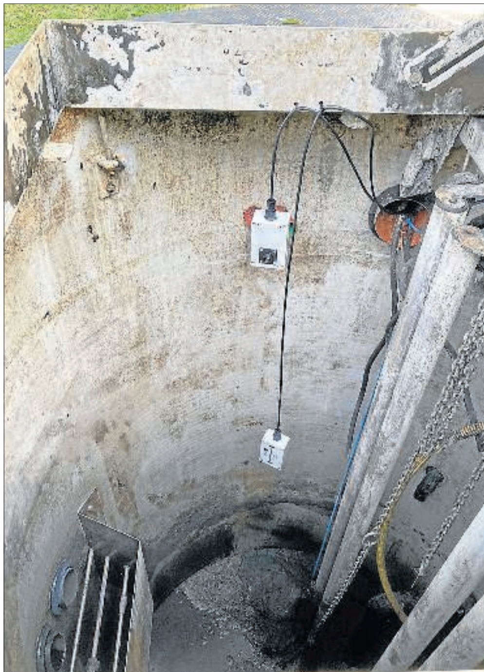
Cloudløsningen bygger på måling af svovlbrinte i oppumpningsbrønden. Her ses on-line sensorer, som registrerer koncentrationen af svovlbrinte i forskellige dybder i brønden. (Foto: Sweco)
